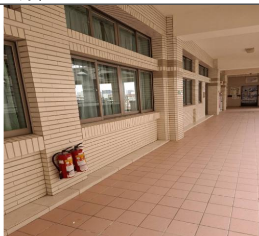
樂齡大學-護理大樓教室走廊消防設備
